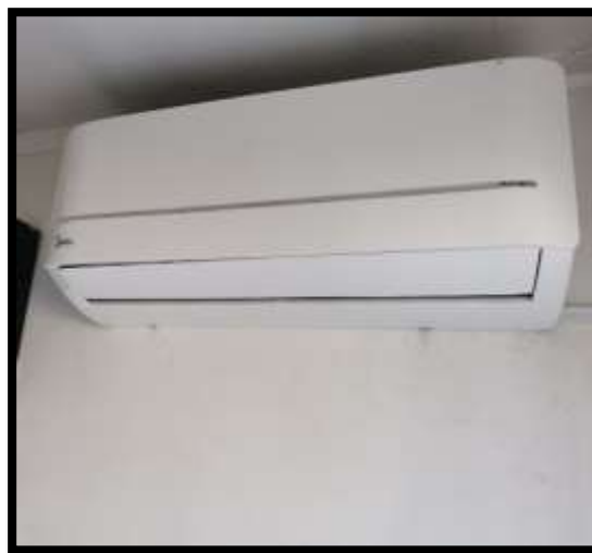
AIRE ACONDICIONADO INTERIORES
