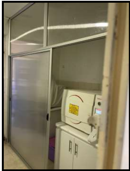
SALA DE ESTERILIZACIÓN
